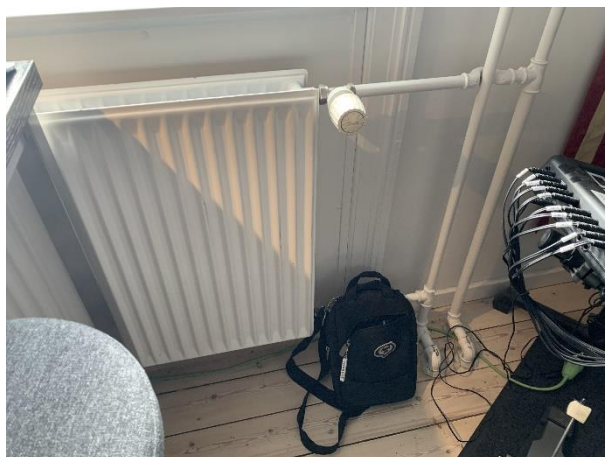
Radiator ud ved facaden.
