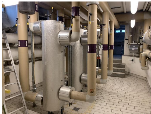
Varmecentral i kælder.
